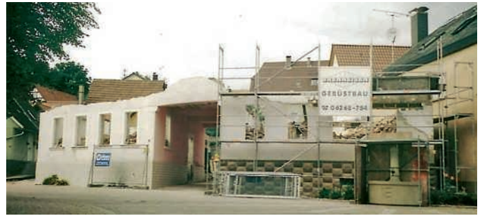
Gesamtfront, ein Stock ist schon abgebrochen
